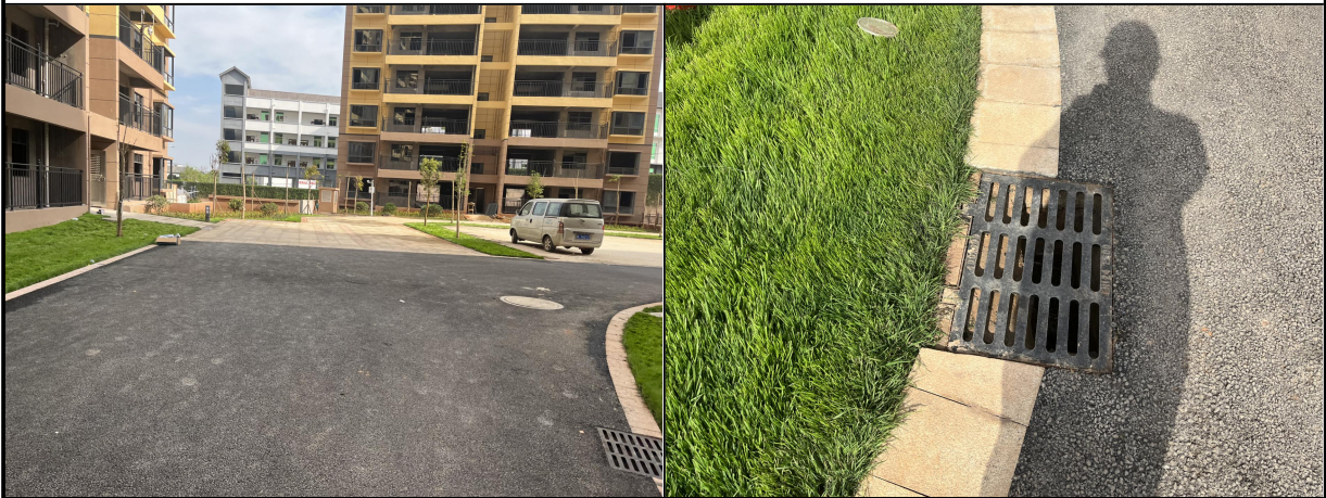
实施的雨水排水管
