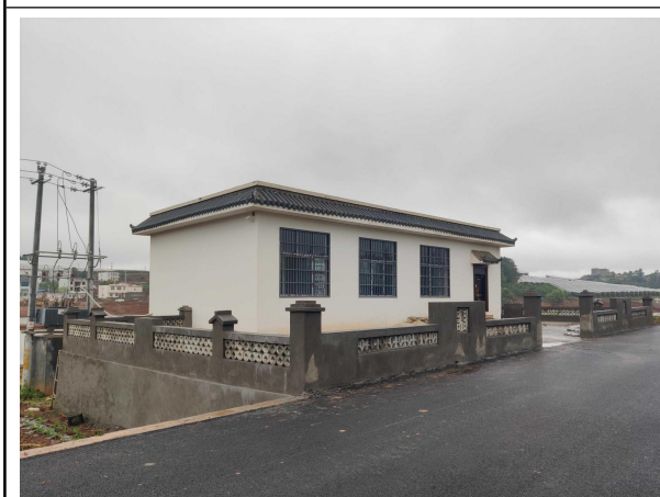
桃源水库现有泵站
